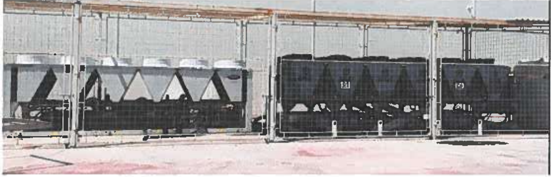
Chiller Soğutma Grubu
