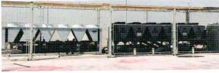
Chiller Soğutma Grubu
