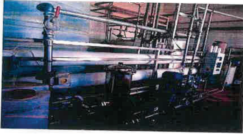
Şekil: Saf Su Üretim Tesisi
