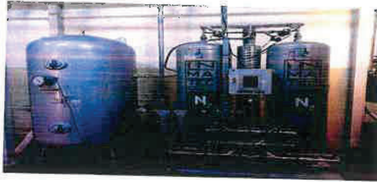
Şekil: Azot Üretim Tesisi
