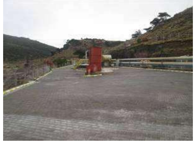
Boru Hattı ve Re-Enjeksiyon Pompası 1
