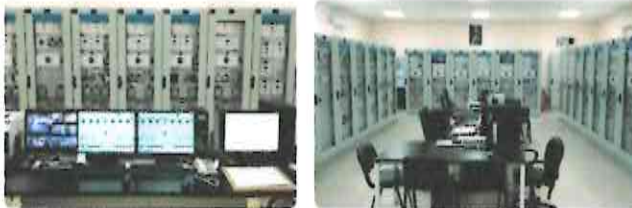
Istanbul Çağlayan 380kV GIS SS
